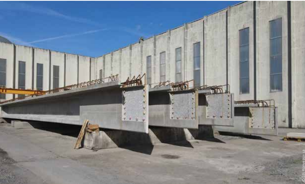
De complexiteit van het project (dat drie overspanningen omvat) vloeit vooral voort uit het feit dat de structuur in kwestie een 'dubbele' helling heeft, die overigens varieert van overspanning tot overspanning.
