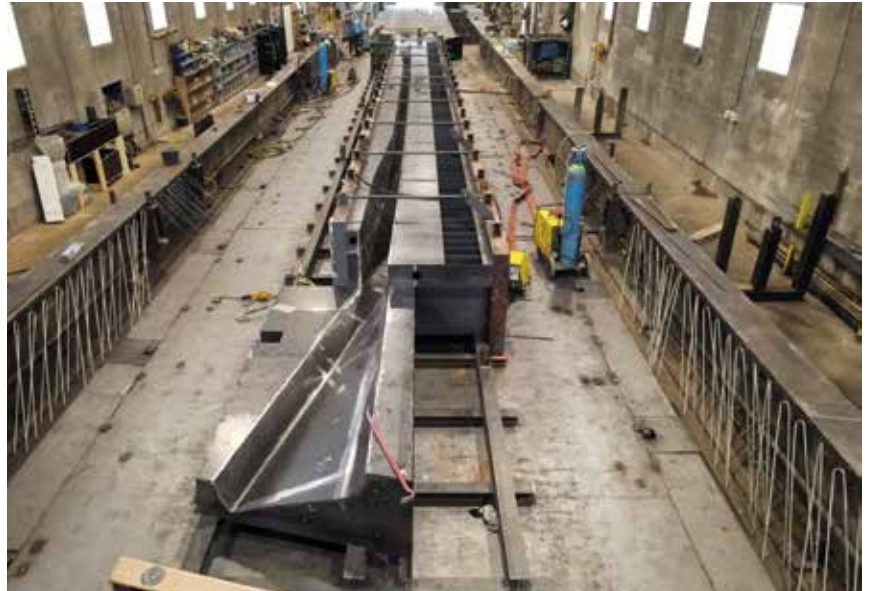
Bekisting Eupen: Gezien de uiterst bijzondere vorm van de liggers vereiste de metalen bekisting die nodig was om ze te prefabriceren een ongeëvenaarde technische vaardigheid en expertise.
